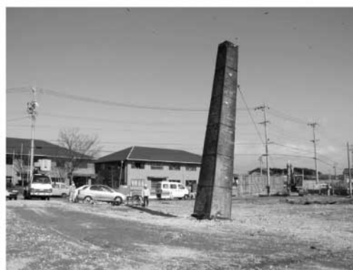
(d) 基部の亀裂発生状況
