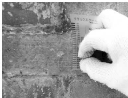
図3-25 引っかかり傷幅測定状況
