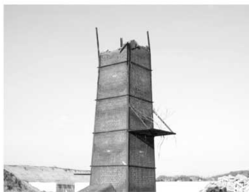
(f) 崩壊状況
