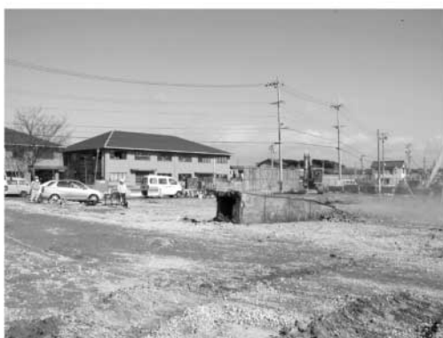
(e) 崩壊状況
