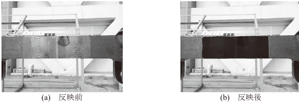
図8 腐食箇所を反映させた写真の例
